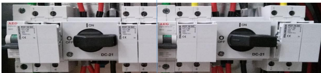
Quadro elettrico Ston
